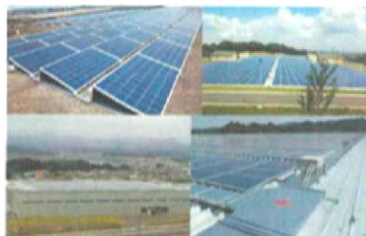
▲屋上賃借により設置した太陽光発電設備
